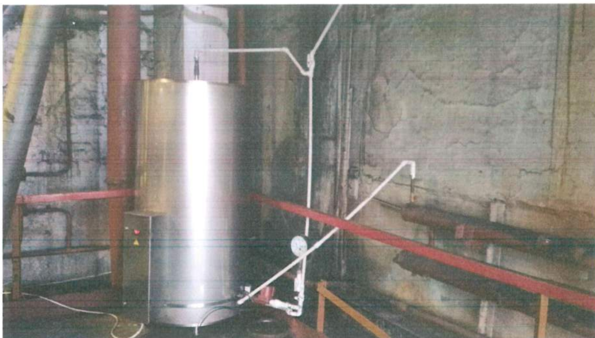
Рис.2.1. Расходный бак подачи раствора на распылительный узел
